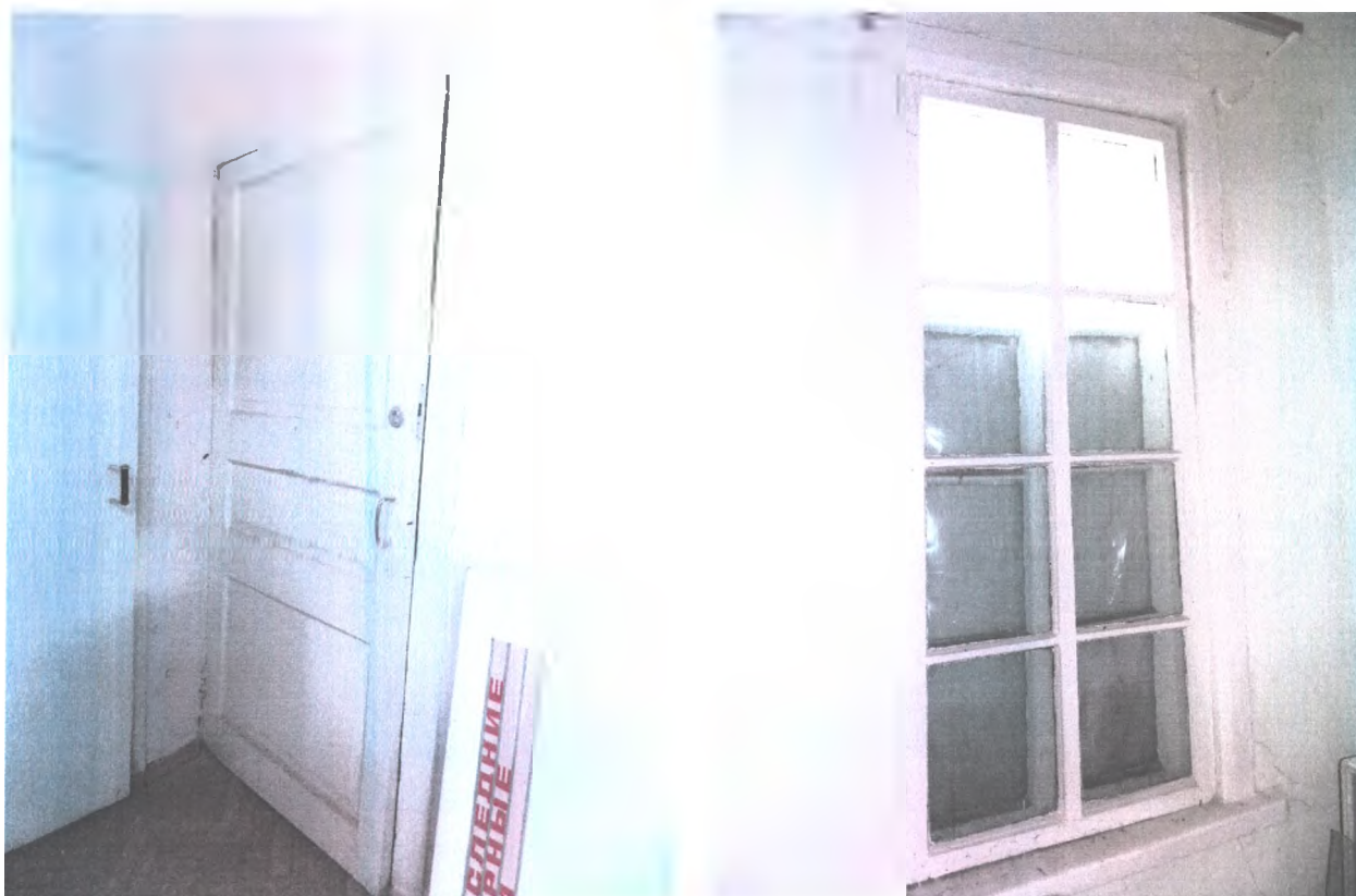
Фото 30-31. Объект культурного наследия федерального значения «Подворье Карповых, где Лермонтов Михаил Юрьевич провел последнюю ночь перед дуэлью», 1841 г., Ставропольский край, г. Железноводск, ул. Семашко, 9/11. Состояние оконных и дверных заполнений (литер Г).
