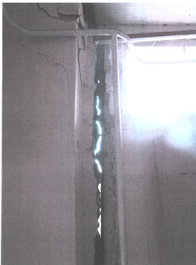
Фото 27. Объект культурного наследия федерального значения «Подворье Карповых, где Лермонтов Михаил Юрьевич провел последнюю ночь перед дуэлью», 1841 г., Ставропольский край, г. Железноводск, ул. Семашко, 9/11. Сквозная трещина в северо-восточном углу (литер Г).
